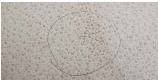
Трещины на поверхности мембраны после воздействия точечной механической нагрузки в холодное время года.
