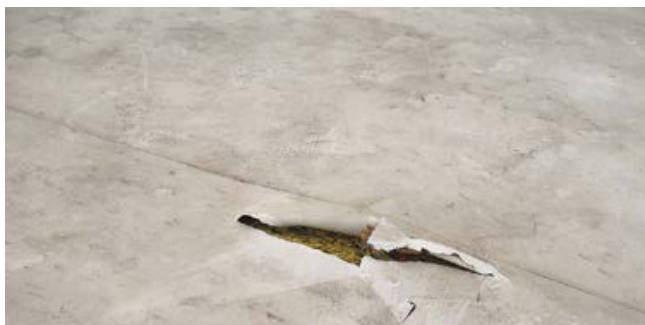
Последствия волочения тяжелых предметов по поверхности кровли при монтаже оборудования.
