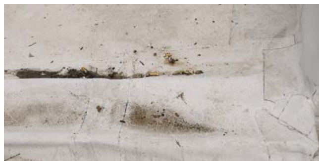
Падение непогашенных окурков сигарет на кровлю. Особенно это касается кровель, расположенных под окнами гостиниц.
