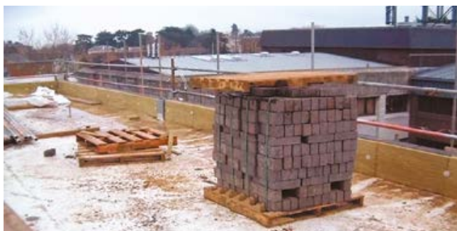
Складирование строительных материалов на кровле, выполненной из полимерной мембраны.
